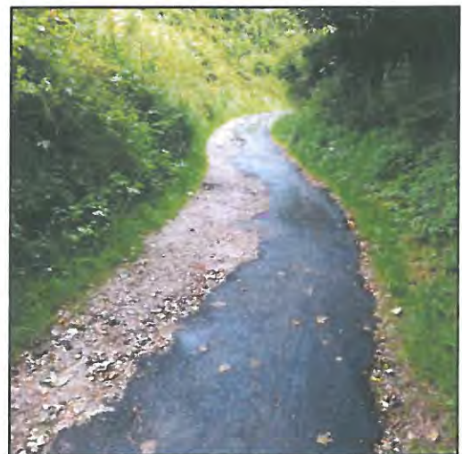
Figure 34 - Dégradation de l'enrobé dans la valleuse de Vasterival (ASA Vasterival, 2012)
