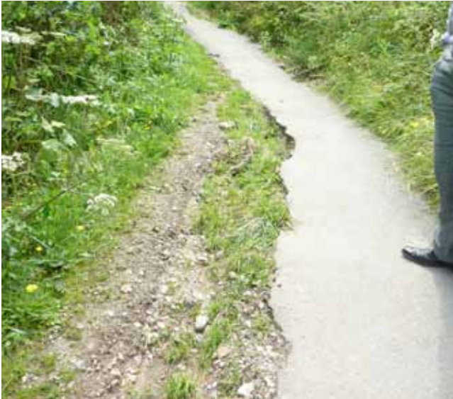
▲ Le ruissellement des eaux pluviales non maîtrisé entraîne un fort ravinement
