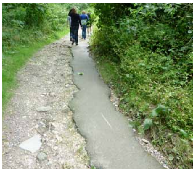
▲ Revêtement enrobé très érodé
