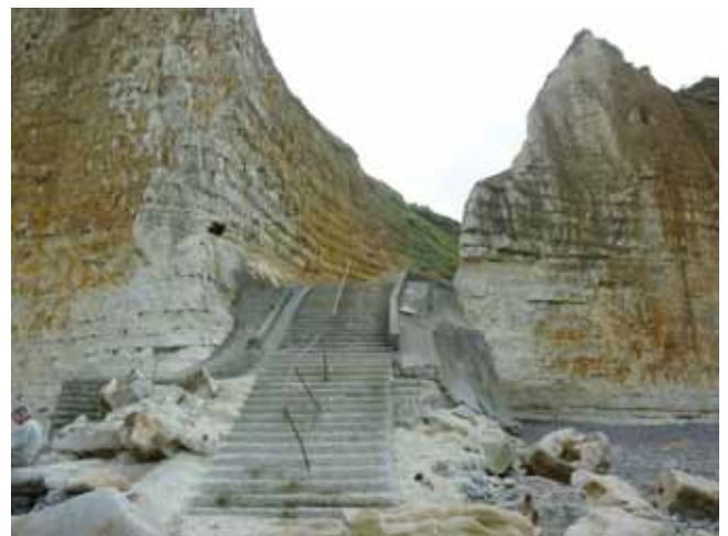
▲ Avançant sur l'estran, l'escalier est fortement soumis à l'érosion marine
