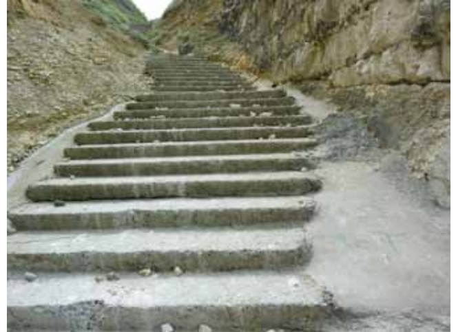
▲ Marches érodées, stabilisées temporairement par des épaulements béton
