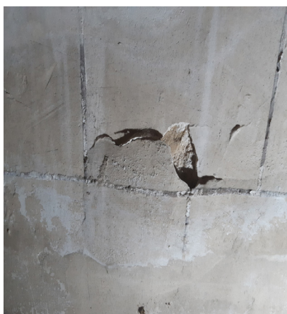
Décollement des enduits chaux
