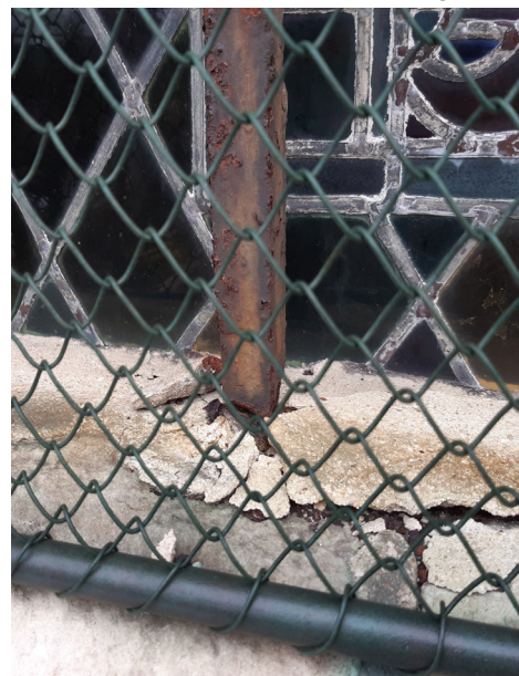
exemple des pierres d'appuis à restaurer
