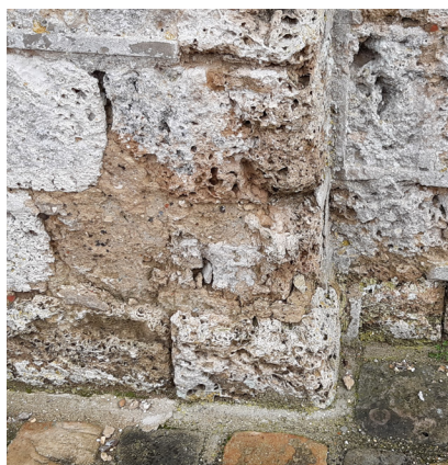
désagrégation aggravé en pied de mur
