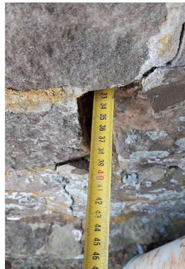
détail du contrefort au droit d'éclatement de jointoiment
