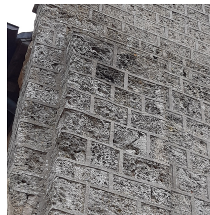
erosion des pierre de Tuf en tête des pilastres
