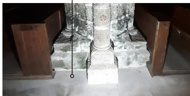
Côté Nord du pilier : couvert de colonisation biologique
