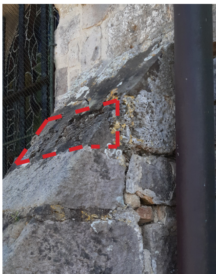
exemple des pierres à remplacer ou à greffer
