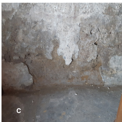
Pulvérulence de l'enduit ciment situé en pied de mur
