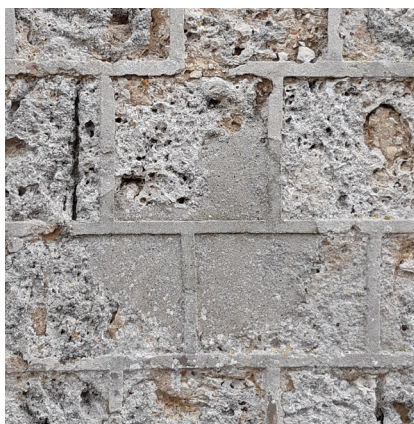
enduit ciment sur pierres Tuf
