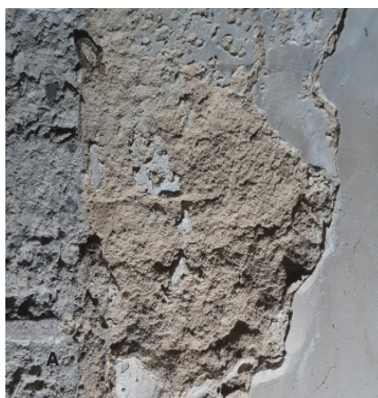
Pulvérulences des enduits chaux
